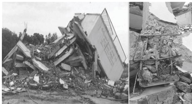
Figura 2.2.2 Colapso del reservorio elevado de 100 m 3 después del terremoto de 7.7 de magnitud BHUJ (India 2001)
