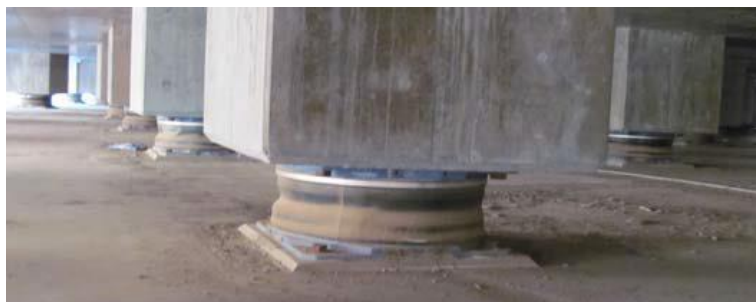
Figura 2.6.6.3 Aisladores instalados en la cimentación de un tanque para almacenamiento de gas natural líquido. Fuente (6)
