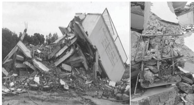
Figura 2.2.2 Colapso del reservorio elevado de 100 m 3 después del terremoto de 7.7 de magnitud BHUJ (India 2001)
