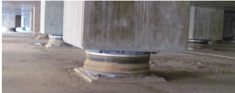
Figura 2.6.6.3 Aisladores instalados en la cimentación de un tanque para almacenamiento de gas natural líquido. Fuente (6)
