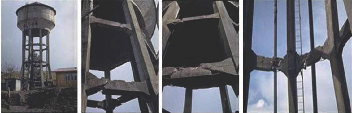
Figura 2.2.1 Daños estructurales de Reservorio Elevado de 50 m 3 después del terremoto de 8.7 magnitud (Chile 1960).
