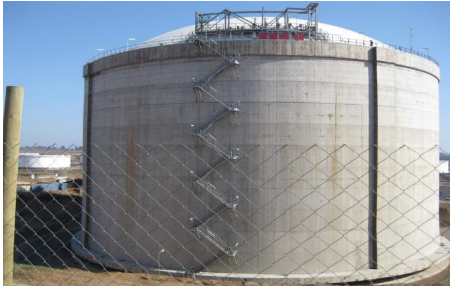
Figura 2.6.6.2 Reservorio para almacenamiento de gas natural líquido con base aislada después del terremoto de Maule 2010 de Magnitud 8.8. Fuente (6)
