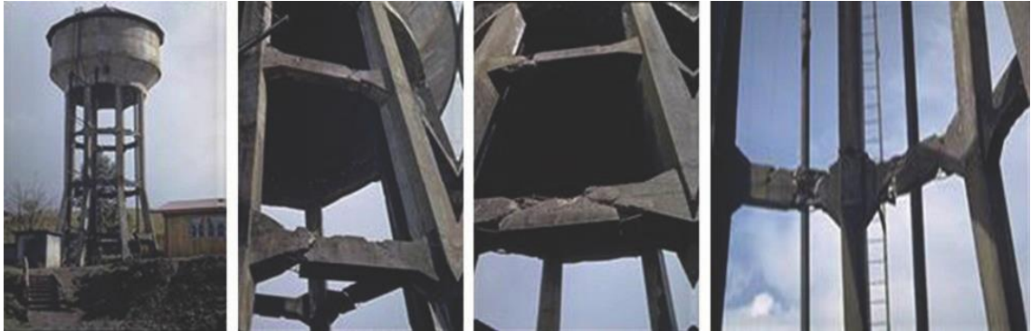
Figura 2.2.1 Daños estructurales de Reservorio Elevado de 50 m 3 después del terremoto de 8.7 magnitud (Chile 1960).
