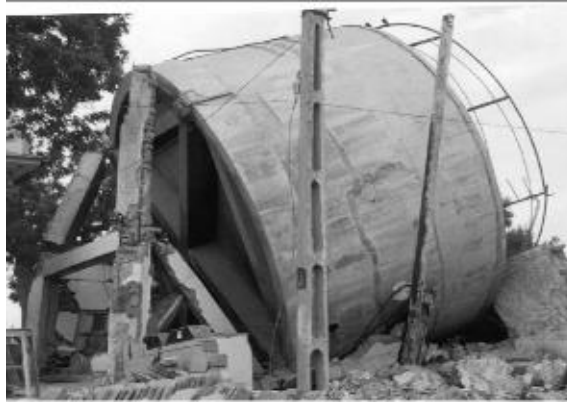
Figura 2.2.3 Colapso del reservorio elevado después del terremoto de 7.2 de magnitud [Argelia, 1980]
