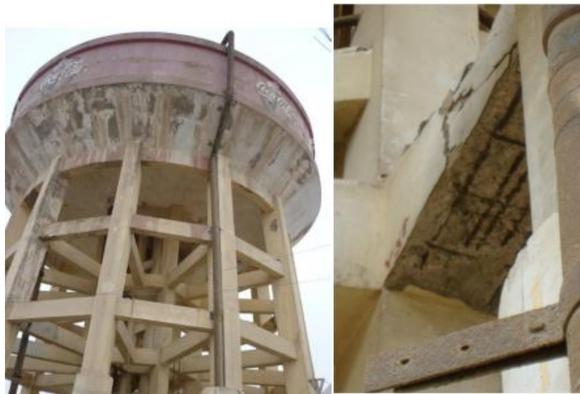
Figura 2.2.4 Falla estructural en viga de reservorio elevado después del terremoto de 7.29 de magnitud [Pisco, 2007].
