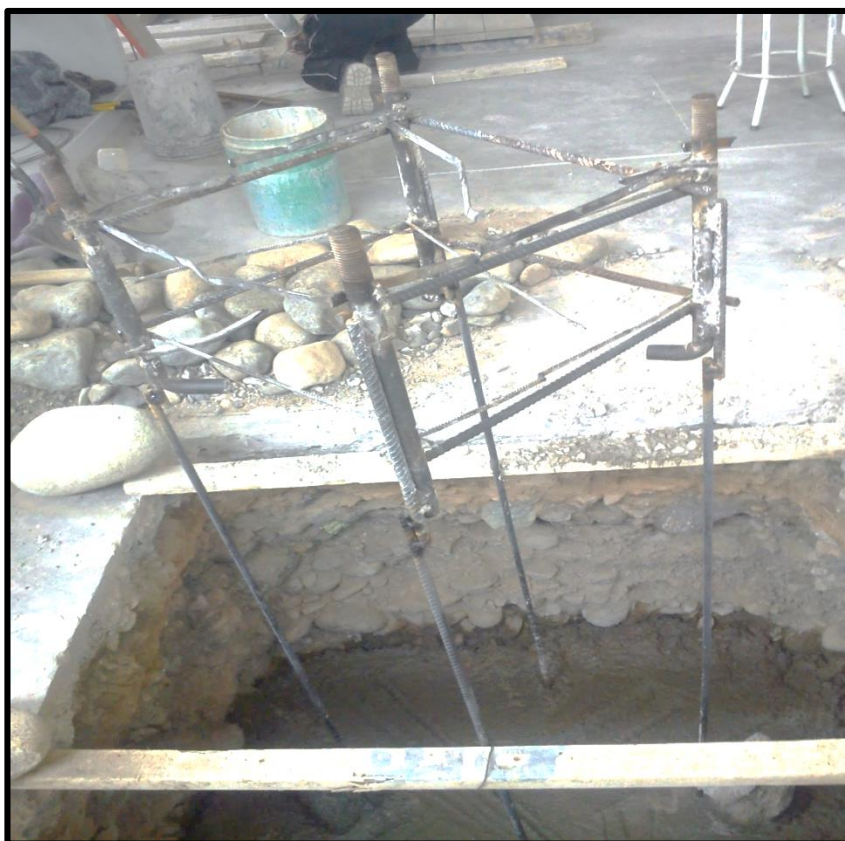
Foto 1. Se observa la colocación de la canasta metálica para posteriormente encofrar y vaciar la parte superior
