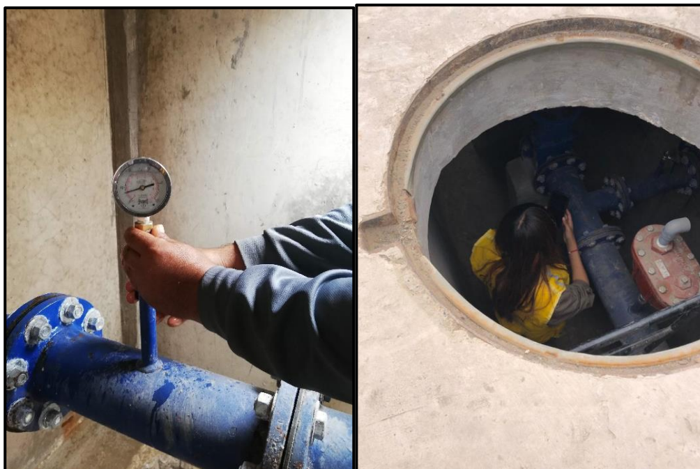
Foto 5: Toma de presión en la cámara de válvulas reguladora de presión, a las 9:00am.
