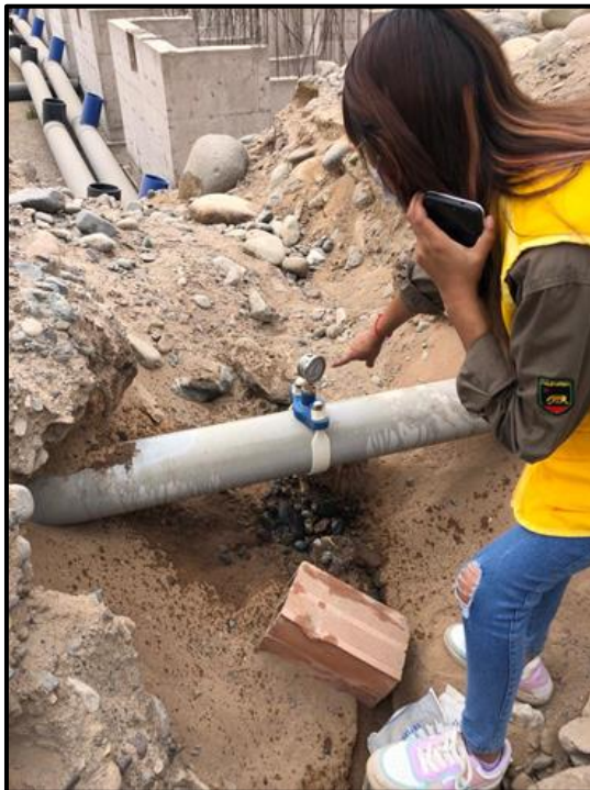
Foto 1: Toma de presión en la Planta de tratamiento de Agua en Calana – EPS Tacna
