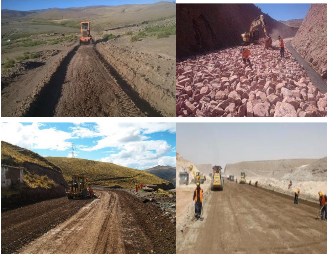
Figura 14 Falla en conformación de sub rasante, sub base granular y base granular
