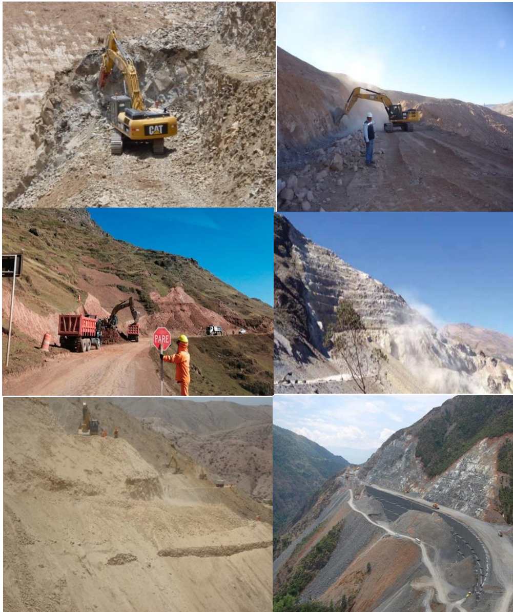
Figura 13 Fallas constructivas en la conformación de taludes
