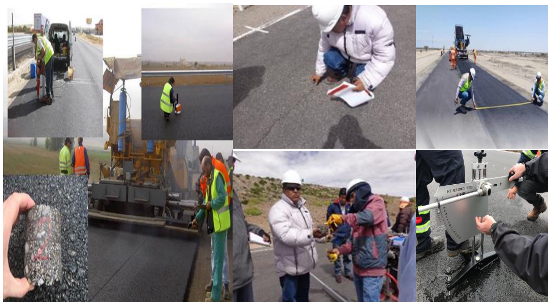
Figura 27 Calidad en construcción de la Infraestructura Vial
