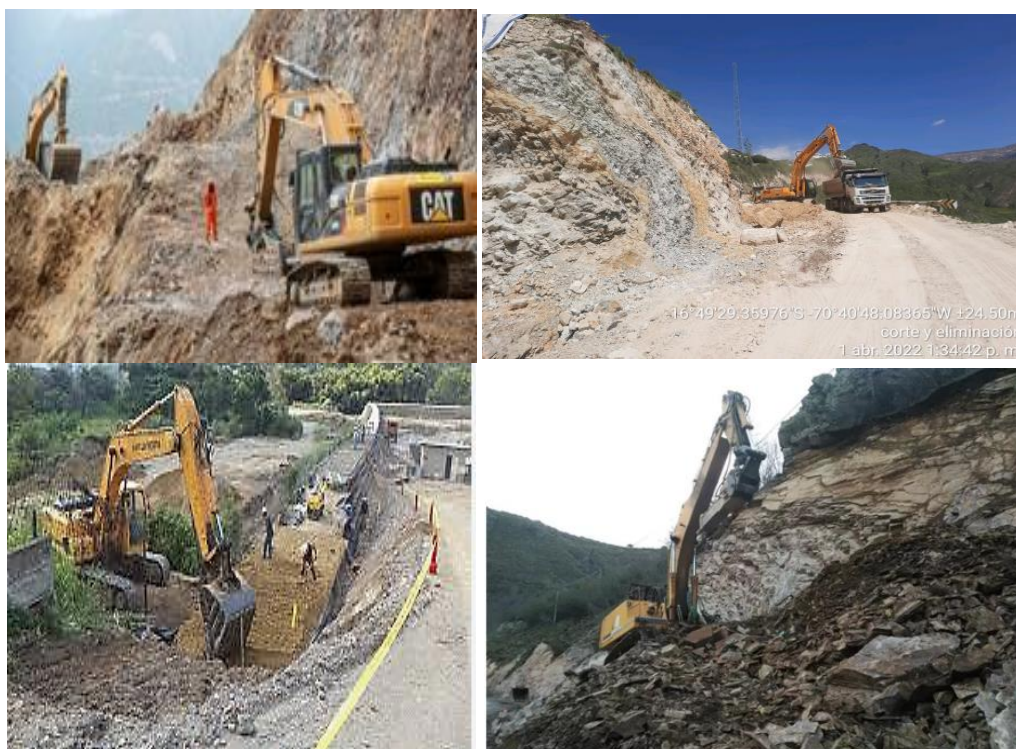
Figura 11 Falla en procesos constructivo en la excavación y construcción de terraplenes
