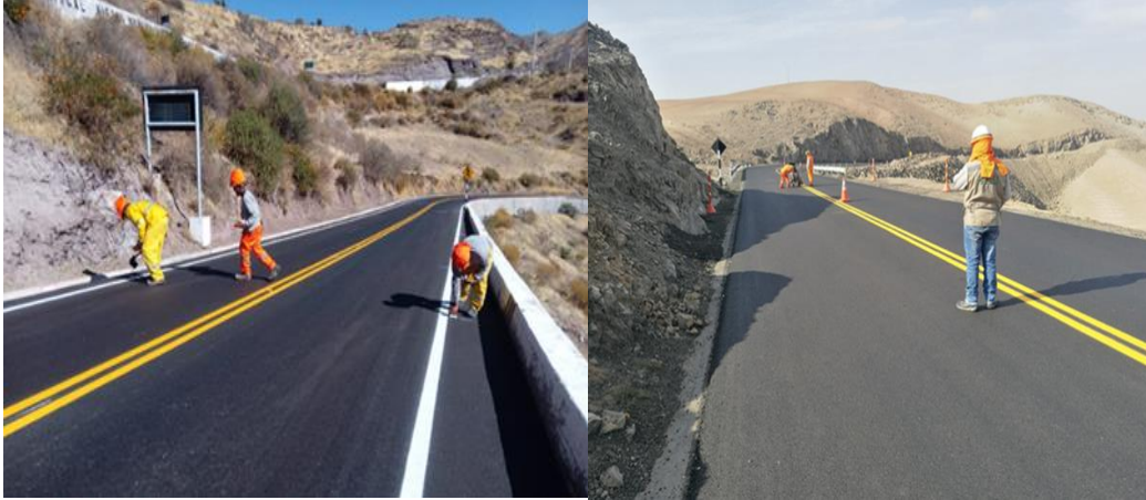
Figura 32 Calidad en construcción de la Infraestructura Vial
