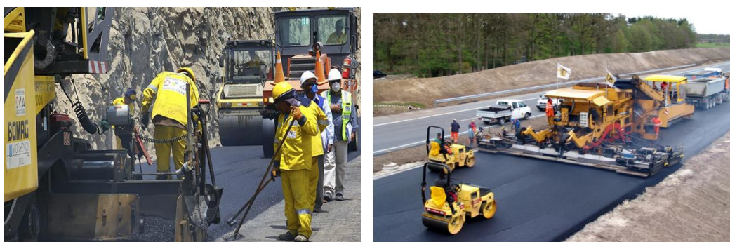
Figura 30 Calidad en construcción de la Infraestructura Vial
