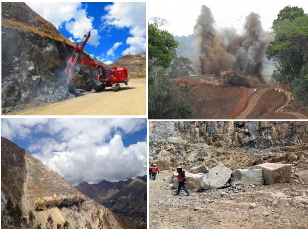
Figura 12 Fallas constructivas, en la perforación y voladura
