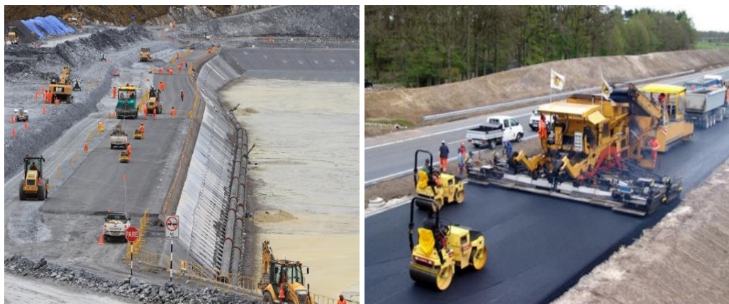
Figura 39 Calidad en construcción de la Infraestructura Vial
