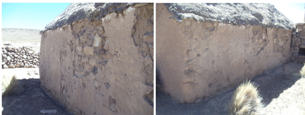
Vistas externas del muro lateral derecho (evangelio), donde se observa el deterioro y desprendimiento de su revoque.
