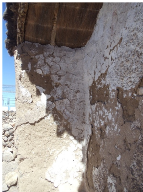
Vista lateral del machón derecho (evangelio) con gran parte de su revoque y yeso desprendido.
