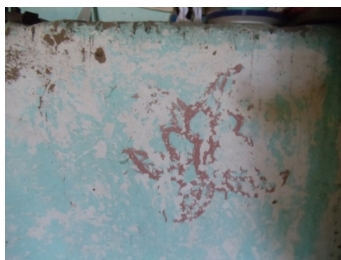
Vista de la degradación de pintura y de los dibujos afectados.
