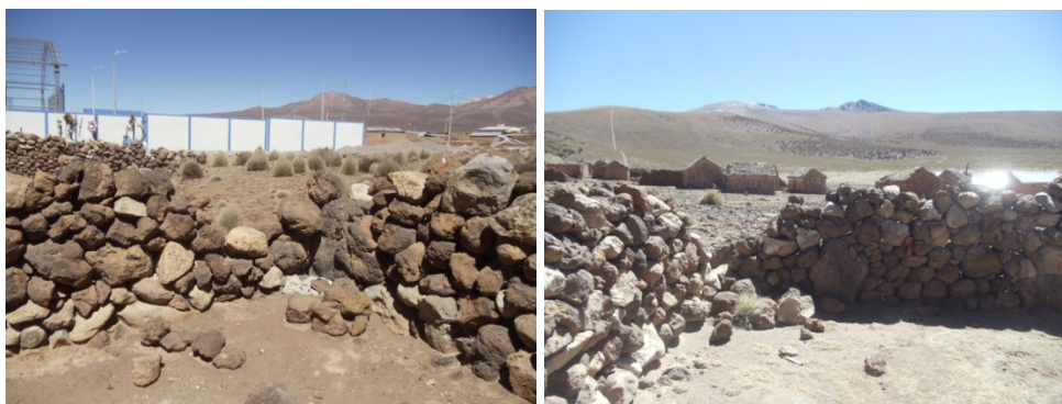
Derrumbe de cerco perimétrico en la parte posterior del mismo.
