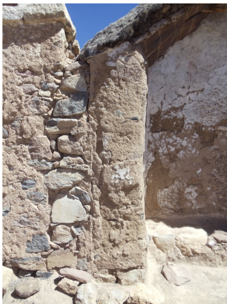
Vista frontal del machón derecho (evangelio) con desprendimiento de revoque y pérdida de
