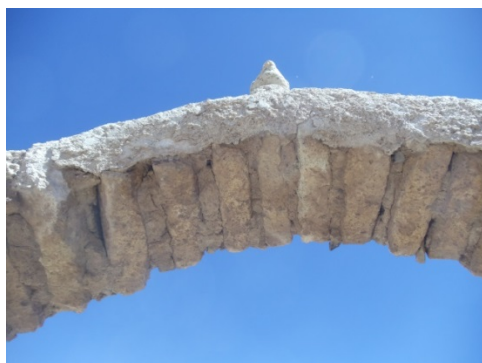
Vista desde abajo del arco, se observan los bloques de piedra y el mortero en mal estado.
