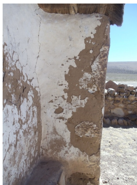
Vista lateral del machón izquierdo (epístola) con desprendimiento de su capa de yeso.
