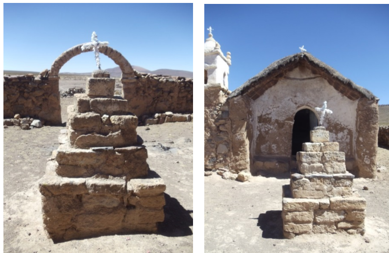
Vistas del estado actual del calvario ubicado en medio del atrio, entre el arco de ingreso y la nave de la capilla.
