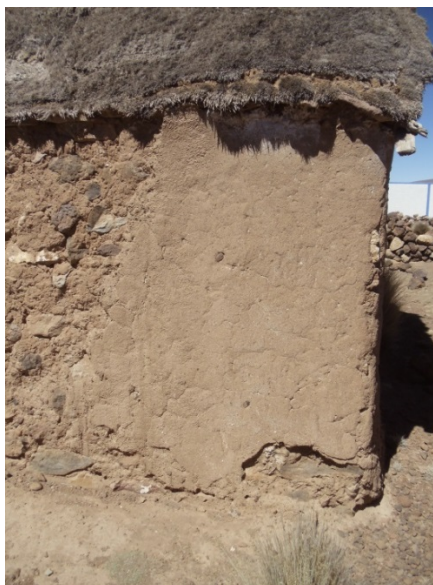
Vista externa de estado actual del muro lateral izquierdo (epístola) donde se ubica el presbiterio.
