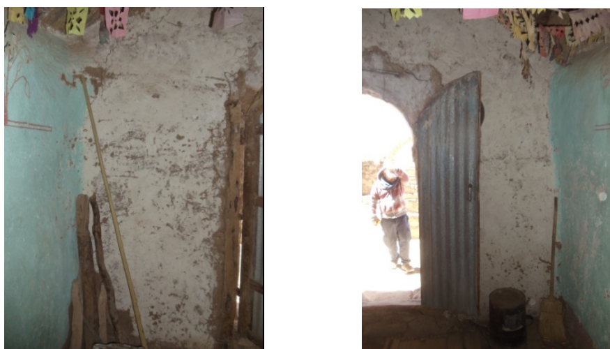
Vistas internas del muro de ingreso a la nave. Se observa su pintura original y deterioro.
