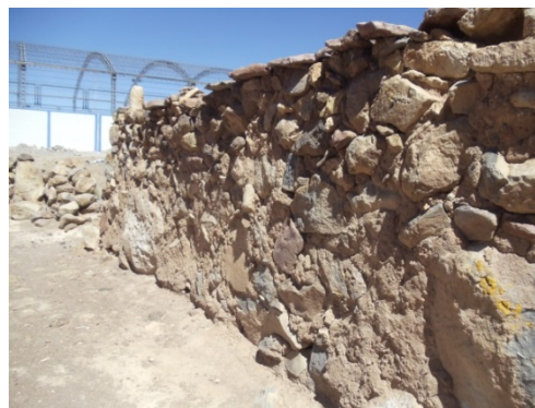
Agosto 2016: Vista frontal del cerco perimétrico donde se observa la pérdida de gran parte del revoque de barro.
