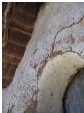
Vista a detalle del desprendimiento de muro sobre el ingreso a la nave.
