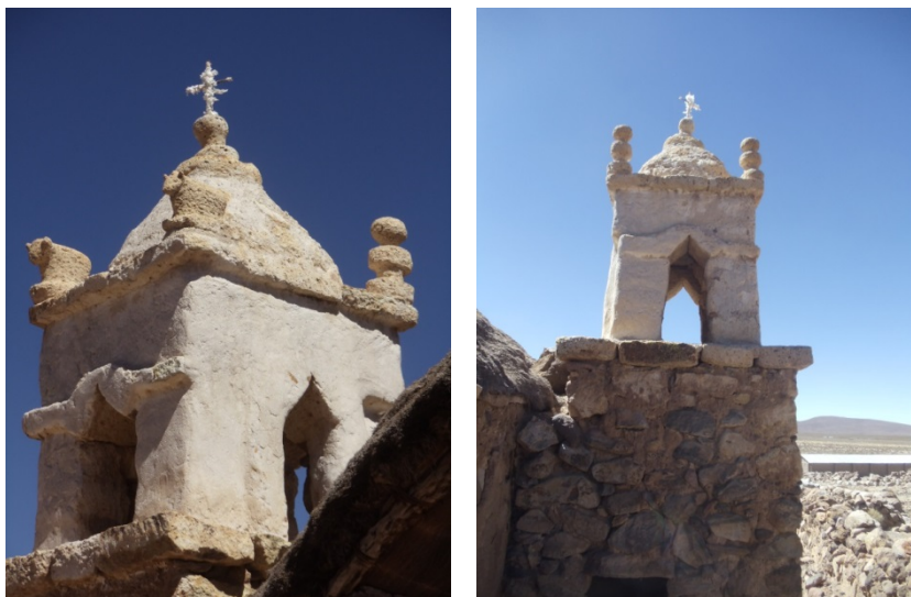
Vistas del campanario en la que se observa el desgaste en su capa de yeso.
