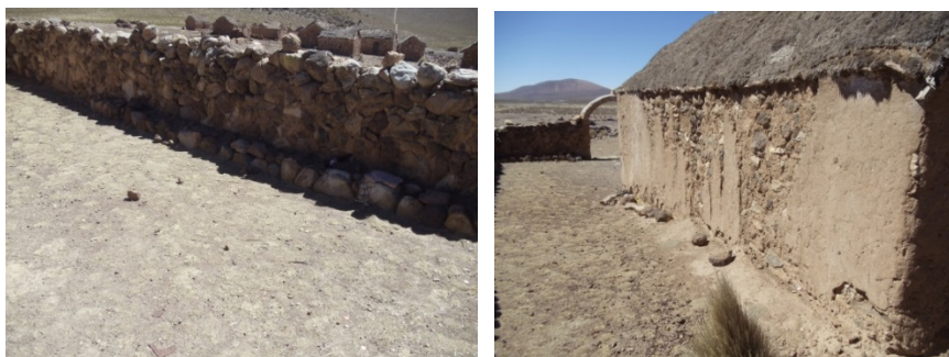
Vistas internas del atrio donde se observa el piso de tierra sin afirmar.
