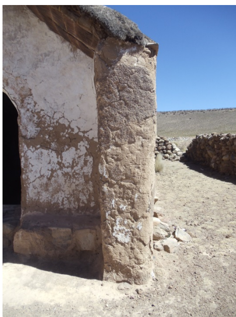
Vista frontal del machón izquierdo (epístola) con desprendimiento de revoque y pérdida de yeso.
