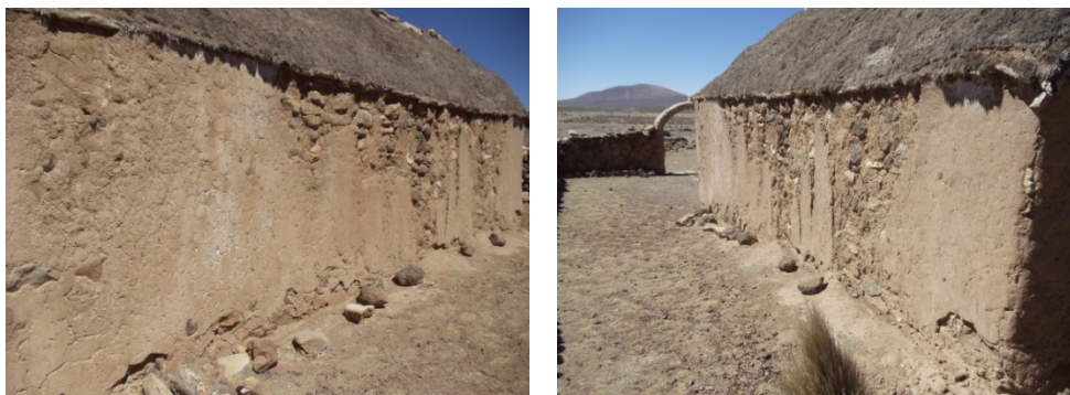
Vistas externas del muro lateral izquierdo (epístola), donde se observa el deterioro y desprendimiento de su revoque.
