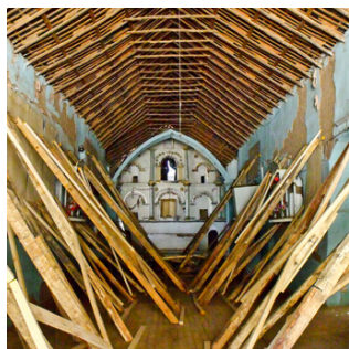
Vista interna de la nave, con evidentes daños.
