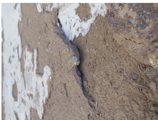
Vista a detalle del desprendimiento del revoque de barro y capa de yeso.
