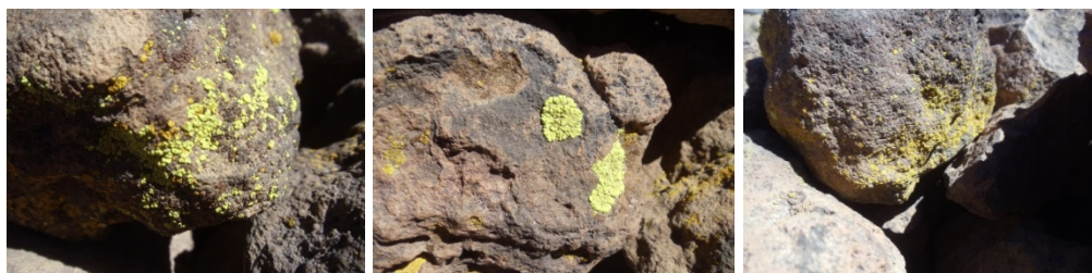
Vistas de microorganismos que atacan la superficie de las piedras pertenecientes al cerco perimétrico.
