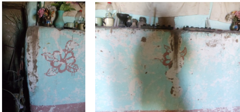
Vistas a detalle de los daños presentes en el altar.
