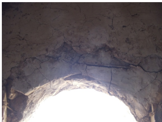
Vista del agrietamiento y fisuras del muro sobre el vano de ingreso. Se observa además el desprendimiento de parte del revoque.
