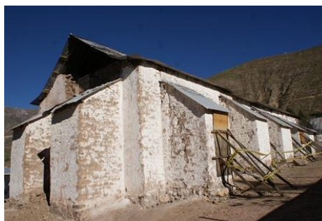
Vista externa del templo donde se aprecian los daños en muros y contrafuertes.
