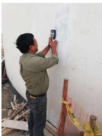
Figura 15. Detector de acero.
