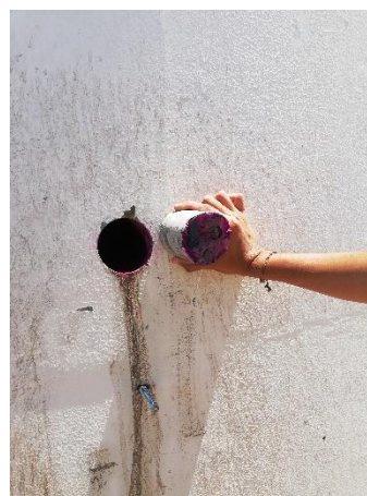
Figura 18. Muestra de concreto.
