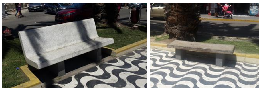
Figura 258. Bancas de concreto Av. Bolognesi, con falta de mantenimiento. Fuente: Estudio de Observación Marzo 2017, Elaboración Propia.
