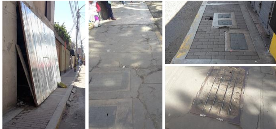
Figura 251. Izq. Ca. Zela, con elemento de interrupción en vereda. Centro. Av. Bolognesi con veredas en mal estado. Der. Tapas de buzón en mal estado. Fuente: Estudio de Observación Marzo 2017, Elaboración Propia.
